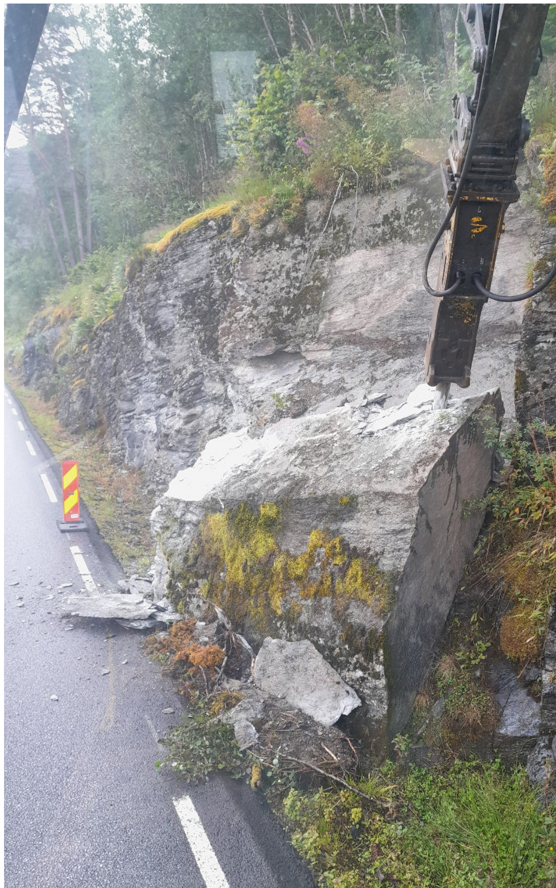
Denne steinblokka lausna og sklei ned i grøfta. Sjølv om blokka ikkje representerte nokon fare, er strekningen utsett. Foto: Olav Hjelmeset AS.
